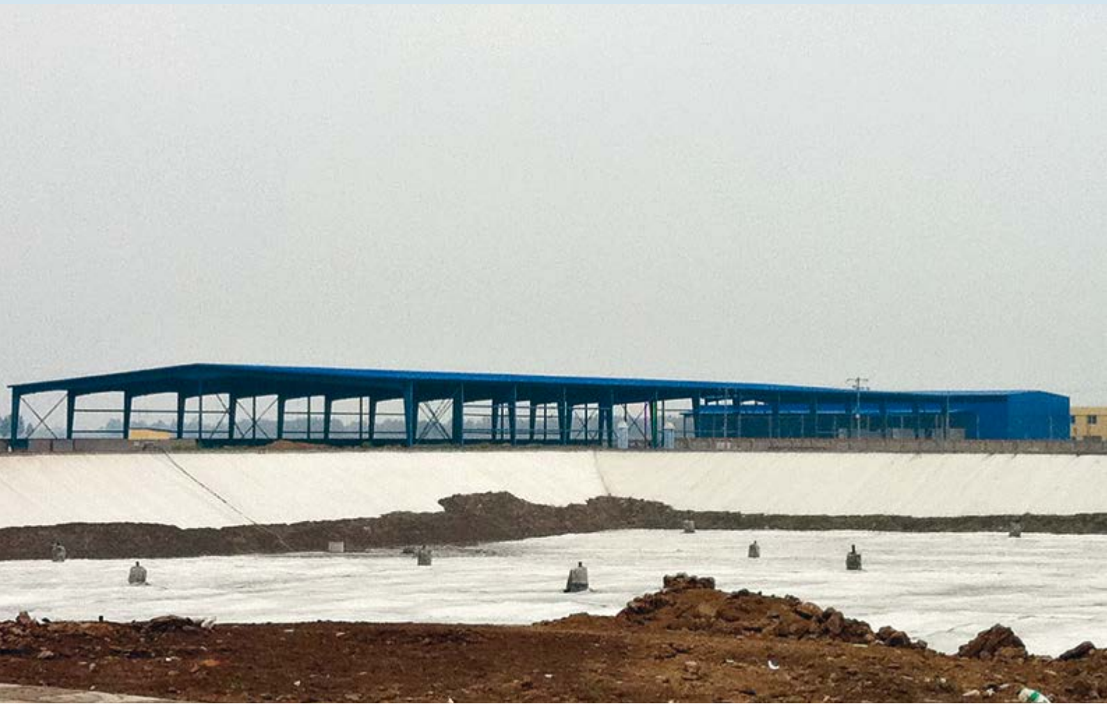
Gesamtansicht des Projektes „Anlage zur methanminimierten Abfallbehandlung“ in Gaobeidian, Provinz Hebei, VR China
