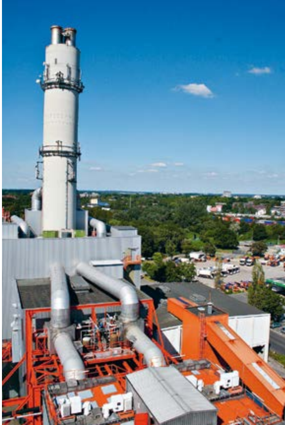
Müllverbrennungsanlage Stelling Moor, Anlagenteil für die Rauchgasreinigung
