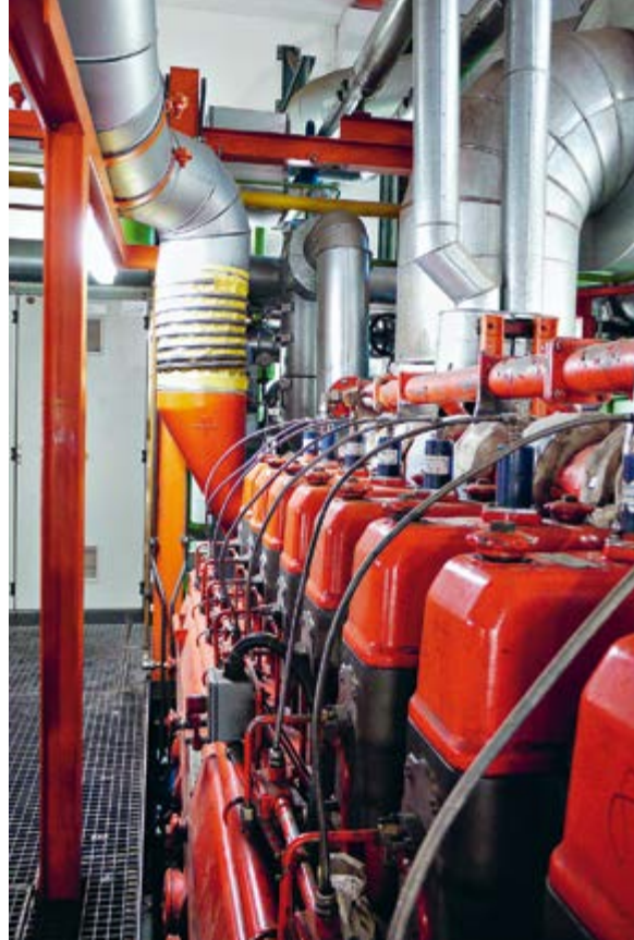
Müllverbrennungsanlage Stelling Moor, Blockheizkraftwerk mit Erdgas als Energiequelle
