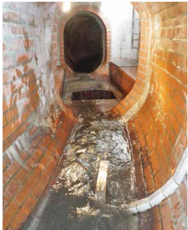
Abb. 1: Online-Sonde im kanalisiertem Auerbach, Modellgebiet Wuppertal, als Teil einer verschmutzungsabhängigen Verbundsteuerung, Foto: Pecher AG, Erkrath
