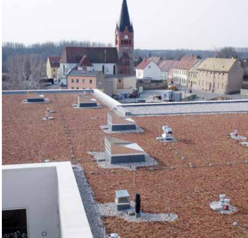
Dachbegrünung zur Regenwasserbewirtschaftung
