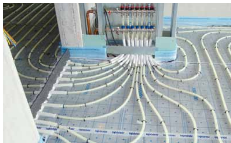
Fußbodenheizung mit Einzelraumregelung
