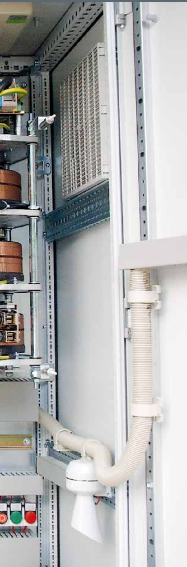
Innenansicht einer typischen Spannungsstabilisierungsanlage
