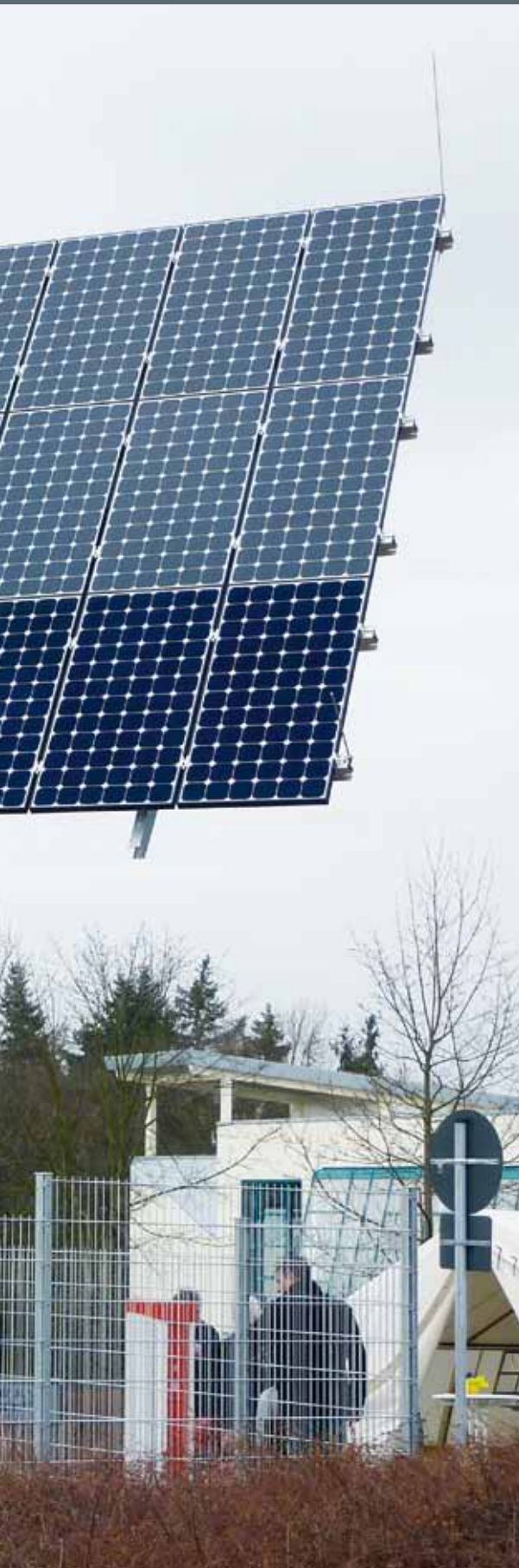
Nachgeführte Photovoltaikanlage der Solartankstelle in Melsungen
