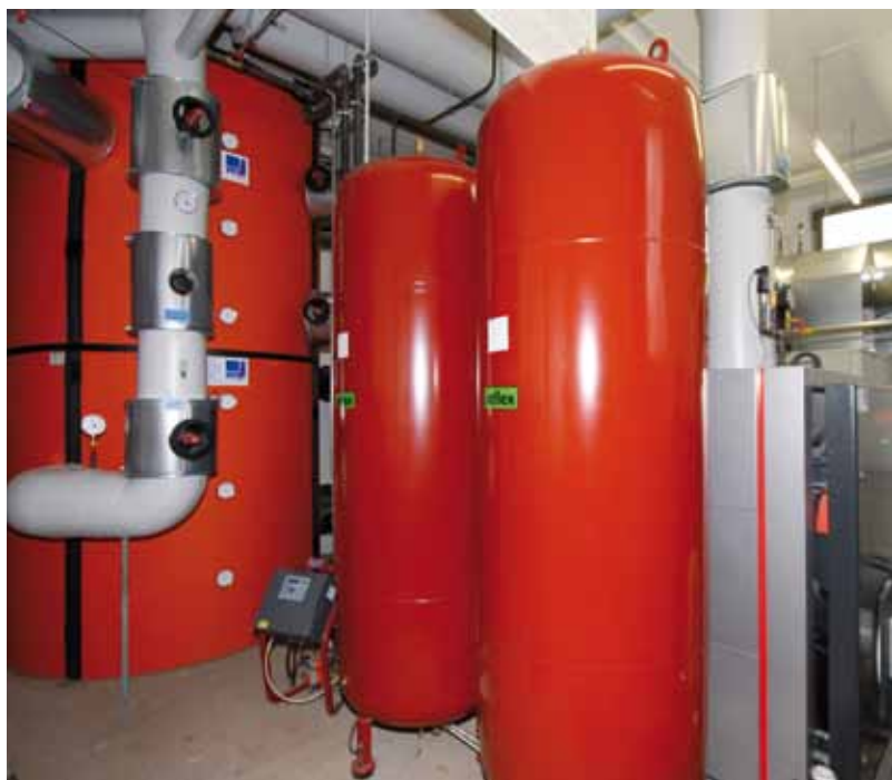
Heizzentrale im Keller der Lichtbergschule Eiterfeld
