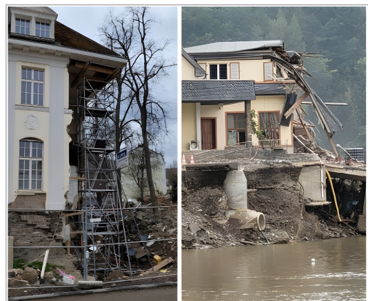
Abb. 13: Schäden im Ahrtal aus Anprall (links) und Unterspülung (rechts)
