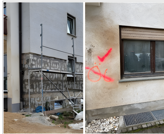
Abb. 12: Schäden im Ahrtal aus Überflutung (links) und Kontamination (rechts)
