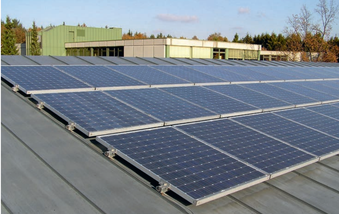
Bürgerphotovoltaikanlage auf der Grundschule am Molzberg in Kirchen
