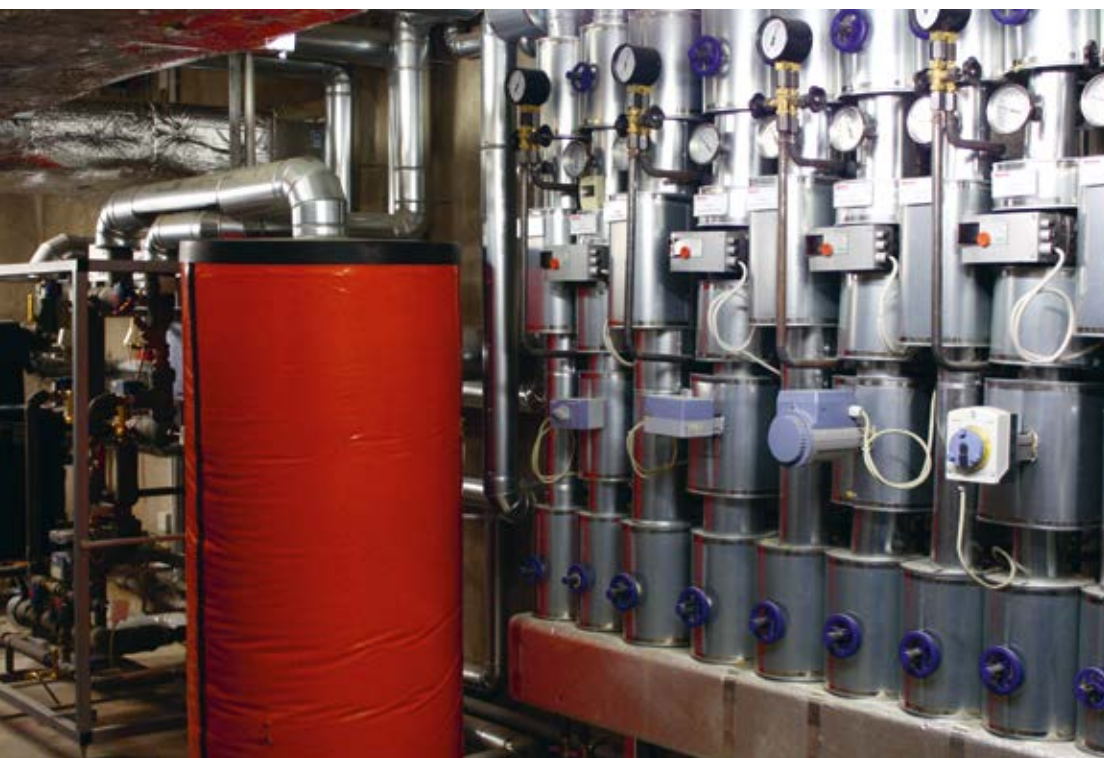
Heizungsanlage in der Sporthalle des Burggymnasiums
