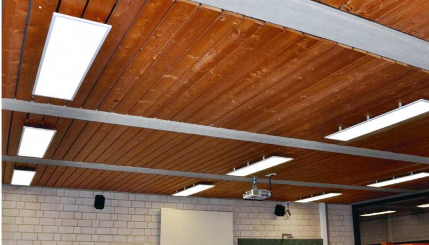
Neue Beleuchtung in einem Klassenzimmer
