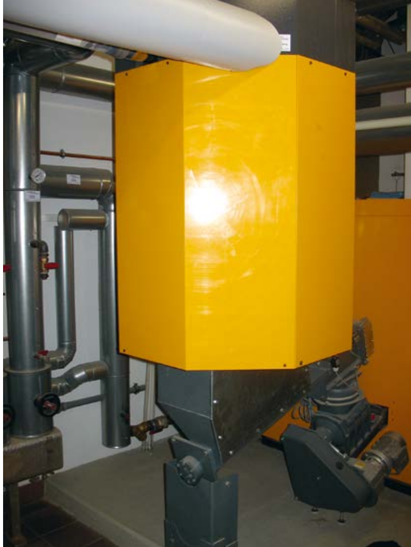
Pelletheizkessel in der städtischen Feuerwache Lauf
