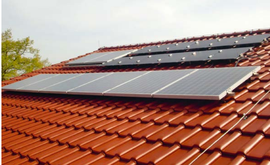
Photovoltaik-Anlage auf dem Evangelischen Gemeindehaus in Burg (Sachsen-Anhalt)
