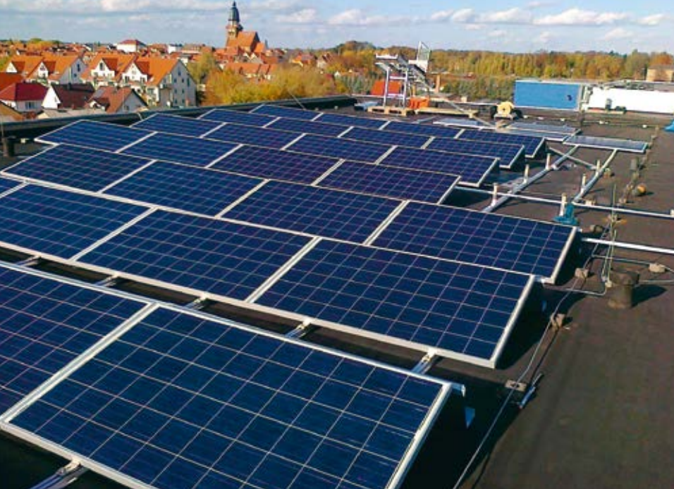
oben: Photovoltaik-Anlage auf der städtischen Regionalschule Friedrich Dethloff
