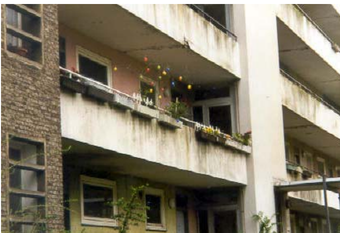
Foto 16 Sahlkampfhäuser - qualitativ schlechte Bausubstanz in den Laubenganghäusern
