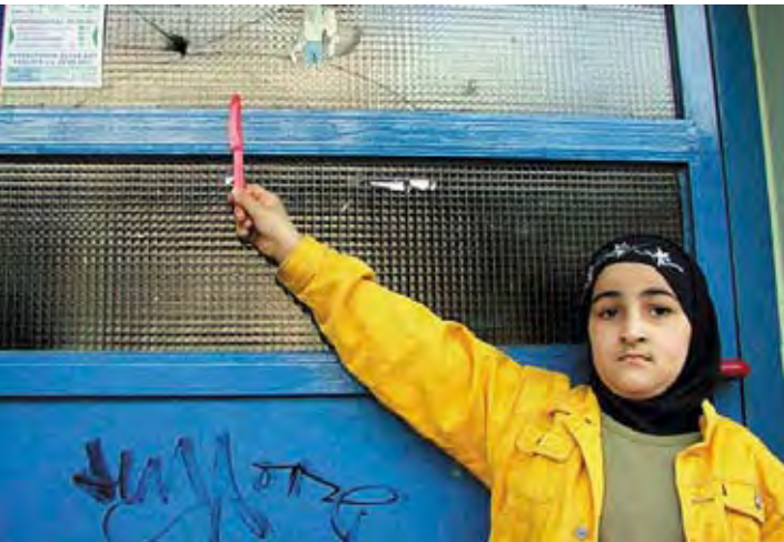
Zerstörte Eingangstüren – das stört auch die Kinder. Bildquelle: Ingeborg Beer, Berlin
