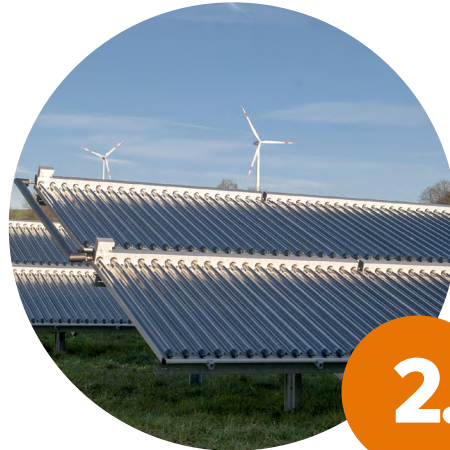
Kollektoren in Neuerkirch im Hunsrück
