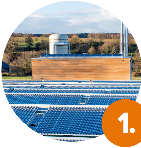
Solarthermieanlage und Heizzentrale in Ellern im Hunsrück
