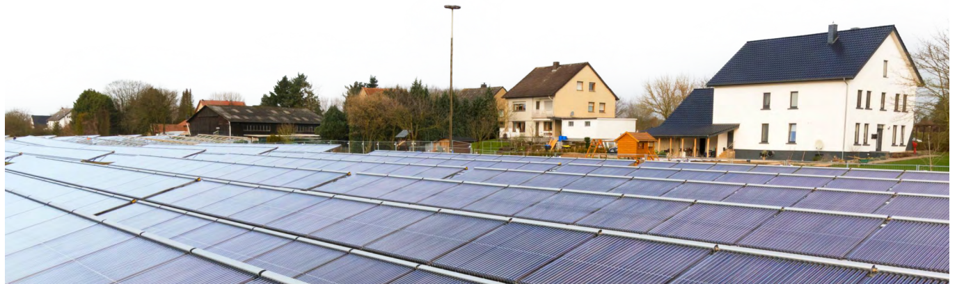
Das Kollektorfeld des iKWK-Systems der Stadtwerke Lemgo.
